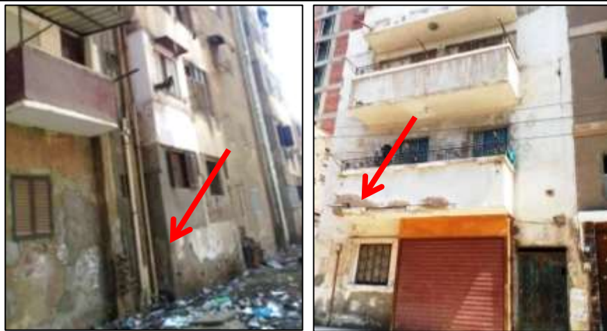
المصدر: من الدراسة الميدانية بتاريخ (٢٠١٧/١١/١٣)، (٢٠١٧/١٢/١٣). صورة (٢) جانب من المباني المتصدعة بمناطق وسط البلد والبلبليسي عام ٢٠١٧ م. المباني المتهدمة (رديئة).
